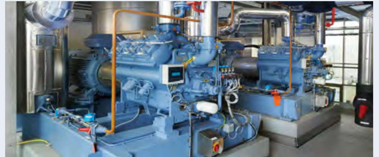
Met industriële warmtepompen kun je efficiënt restwarmte benutten en gebruik van aardgas voorkomen.
